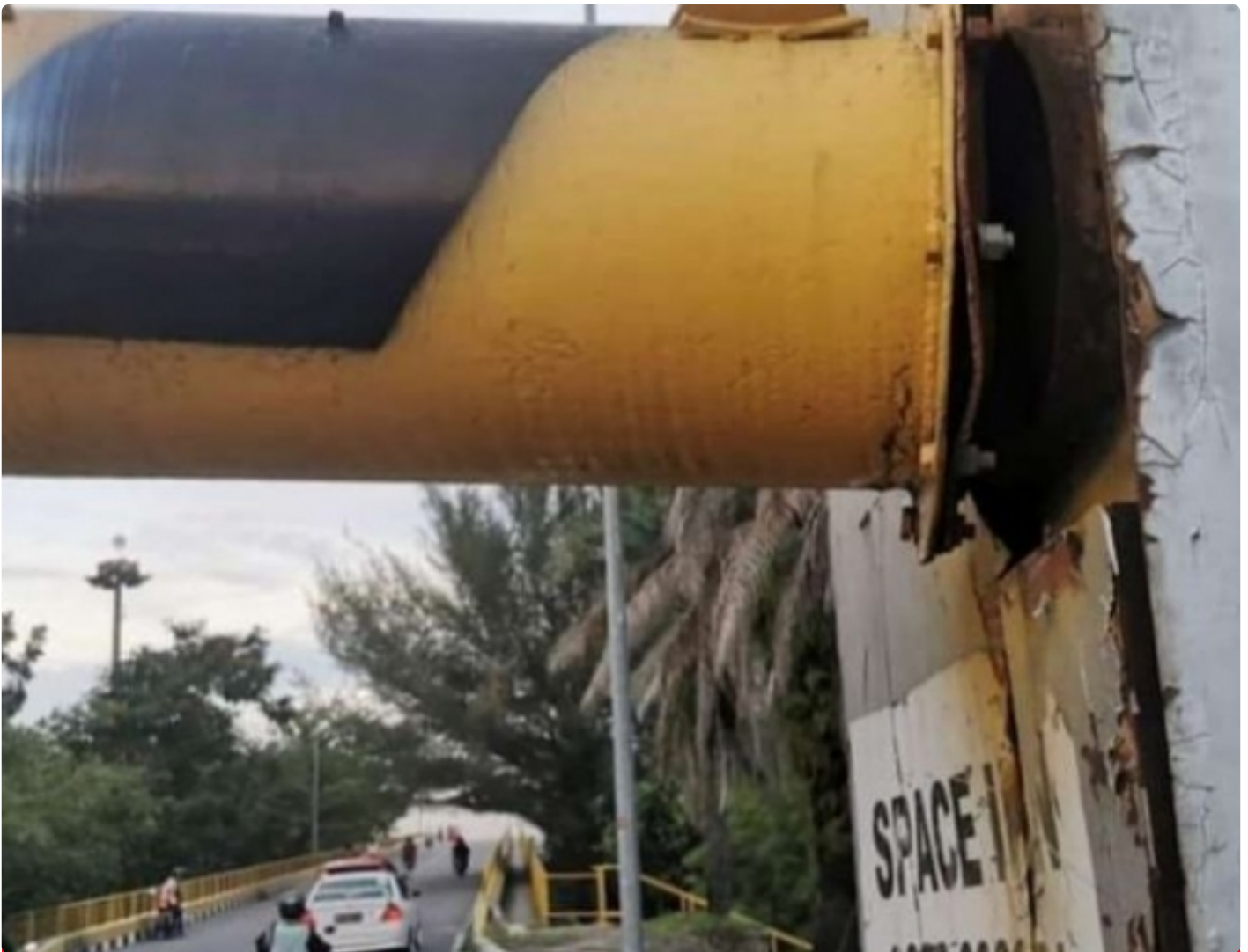
Portal Jembatan Leighton I Rusak Berat PUPR Riau Langsung Turun Tangan
